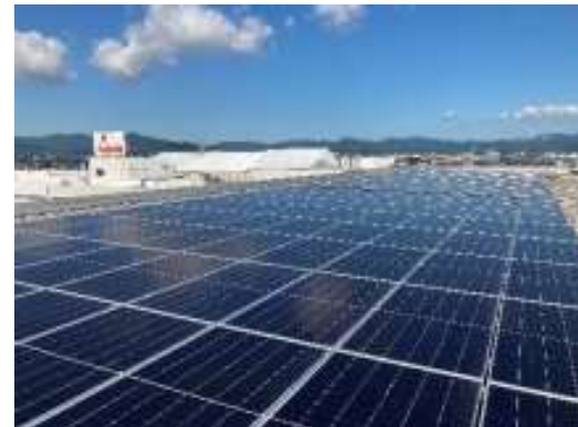
太陽光パネルが設置された小坂井工場
